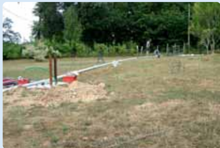
↑ Les 4 éléments (6 mètres de longueur et 10 centimètres de diamètre) du mat tubulaire, en cours d'assemblage.
