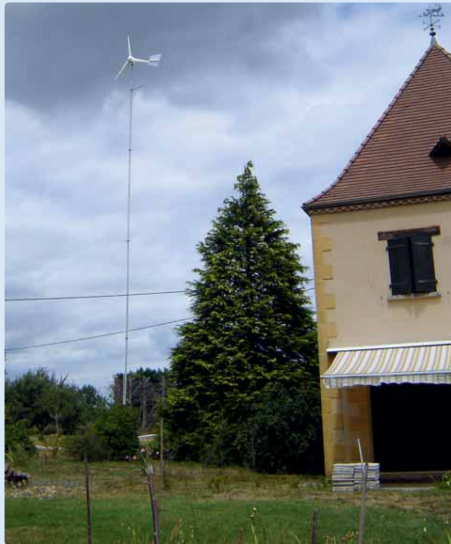
† L'éolienne de 3,60 mètres de diamètre, sur son mat haubané de 24 mètres.
